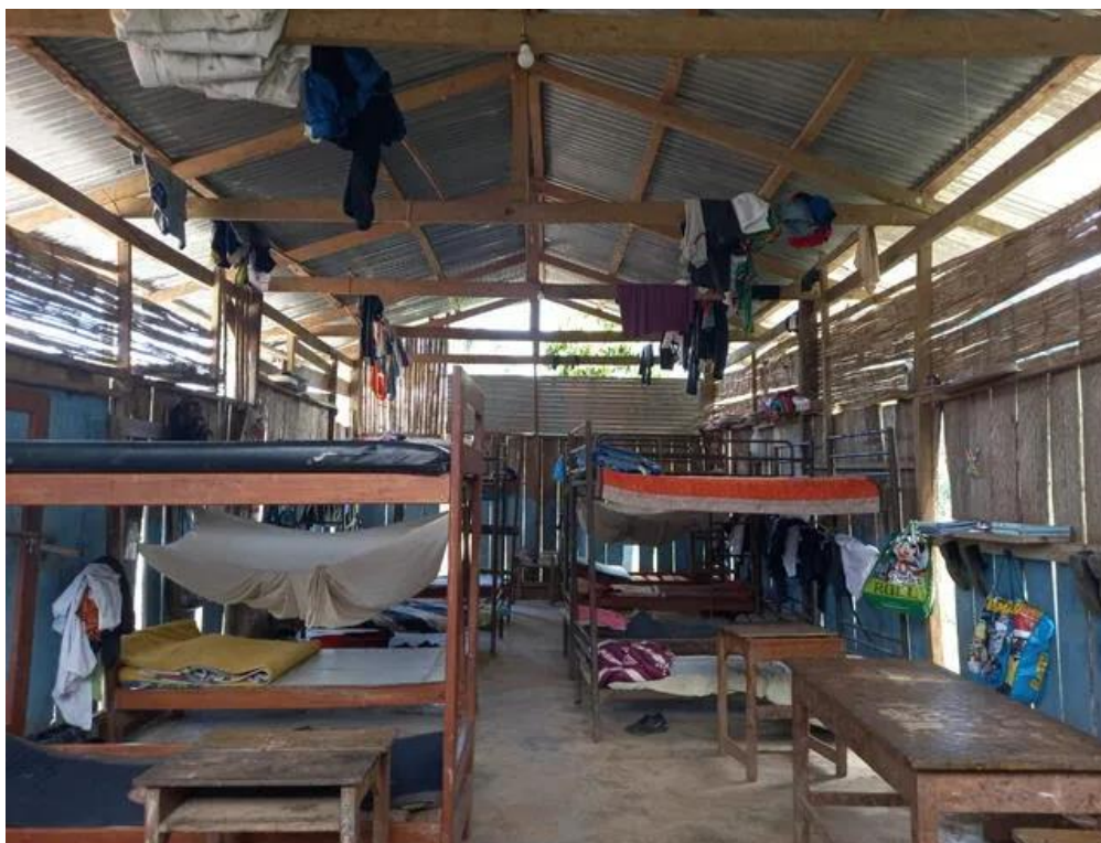
Residencia Yumilus se encuentra en estado de deterioro. Foto: Rosemary Ploc
